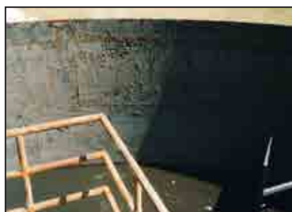
Revêtement en époxyde de goudron défectueux
